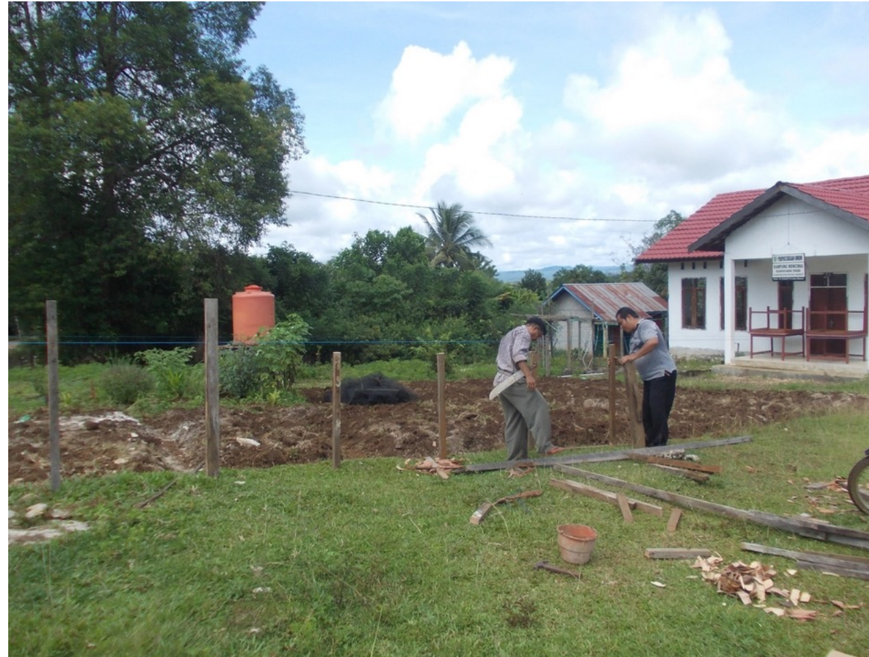
Suatu Kampung melaksanakan Pekerjaan Pembangunan Pagar sederhana di Kampung dengan memanfaatkan suber daya warga yang tersedia, pengadaan ini dilaksanakan dengan swakelola
